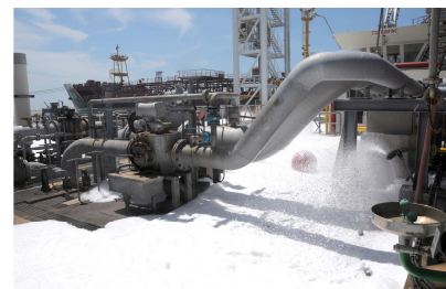
Activation du réseau mousse.
